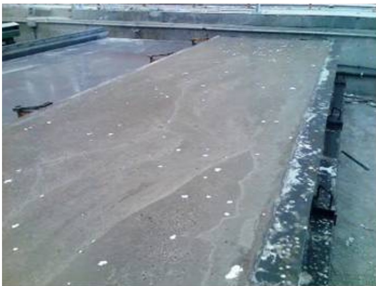
Fig.4. Eflorescencias en Prefabricado. En hormigones con cuantías de cemento elevadas con alto contenido en clínker y altamente alcalinos se libera gran cantidad de hidróxido sódico y potásico que, en tiempos calurosos, se transporta rápidamente a la superficie debido a los gradientes de humedad existentes. Si la superficie tiene una exposición directa, tal y como muestra la figura, la carbonatación temprana puede producirse.
